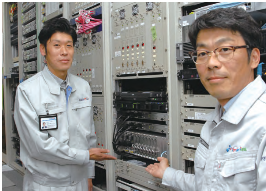
SDNのヘッドエンドセンターで稼働中のミハル通信製ヘッドエンド装置(上からCATV監視装置、受信点監視装置、ヘッドエンド「MDSRシリーズ」)
