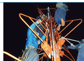
震災直後の余震が続く時期に、地上333mの東京タワー最上部でFCBが行なったアンテナ支柱の補強工事(写真提供:ミハル通信)
